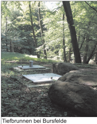
Tiefbrunnen bei Bursfelde
